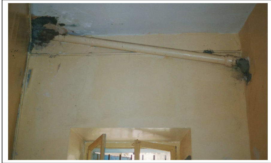
Photo n°4 : infiltration des eaux usées dans les chambres
