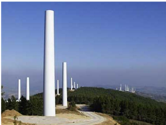
Figure I-4 : Pylônés tubulaires d'un futur parc Eolien.
