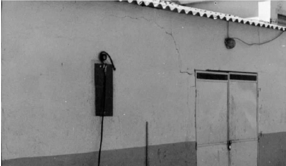
a) Apparition des fissures sur les murs
