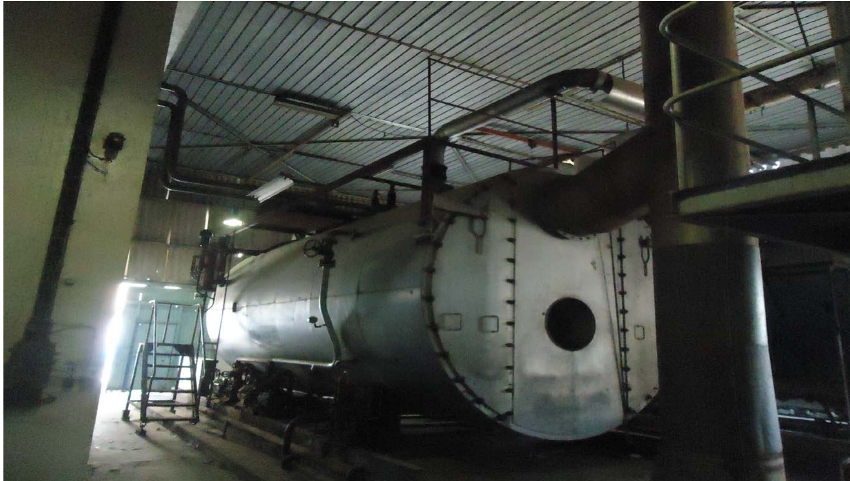
Figure III.6: Chaudière à vapeur.
