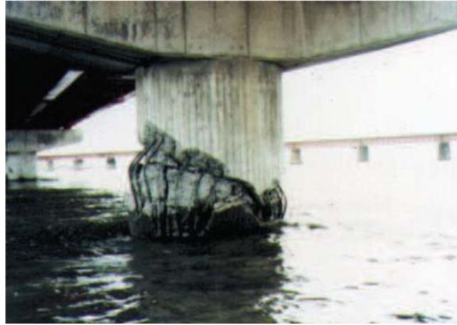
Figure 1.4 : Rupture par cisaillement d'une pile de pont- Shizunai Bridge [82]
