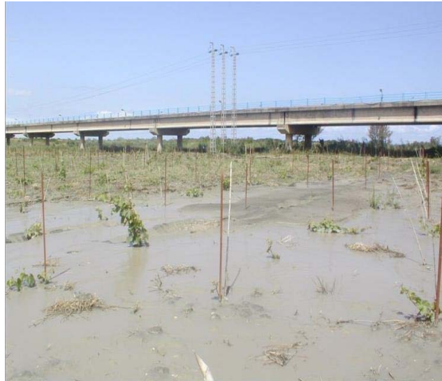
Figure 1.14 : Liquéfaction du sol au niveau d'Oued Isser [29]
