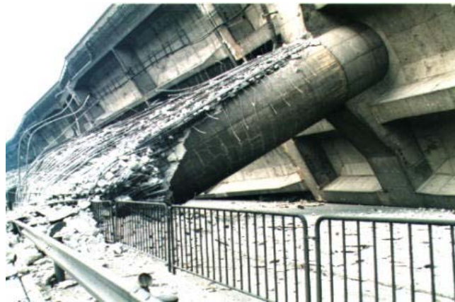
Figure 1.5 : Rupture du type flexion-cisaillement du viaduc de Hanshin, lors du séisme de kobé [82]
