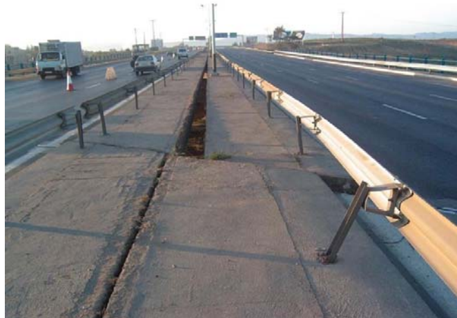
Figure 1.6 : Déplacement horizontal du tablier d'un pont sur Oued El Harrach sens Ben Aknoun -Dar El Beida suite au séisme de Boumerdès en 2003 [29]
