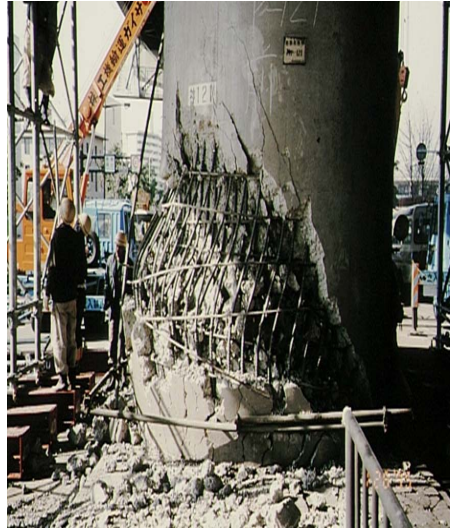
Figure 1.2 : Rupture par manque de ductilité à la base de la pile durant le séisme de Kobé en 1995 [23]
