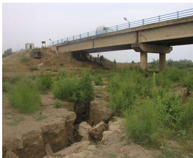
Figure 1.16 : Affaissement de terrain au niveau de l'ouvrage à Oued Isser [29]
