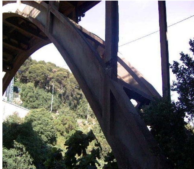
Figure 1.8 : Eclatement du poteau de liaison tablier-arc du pont Hydra [29]
