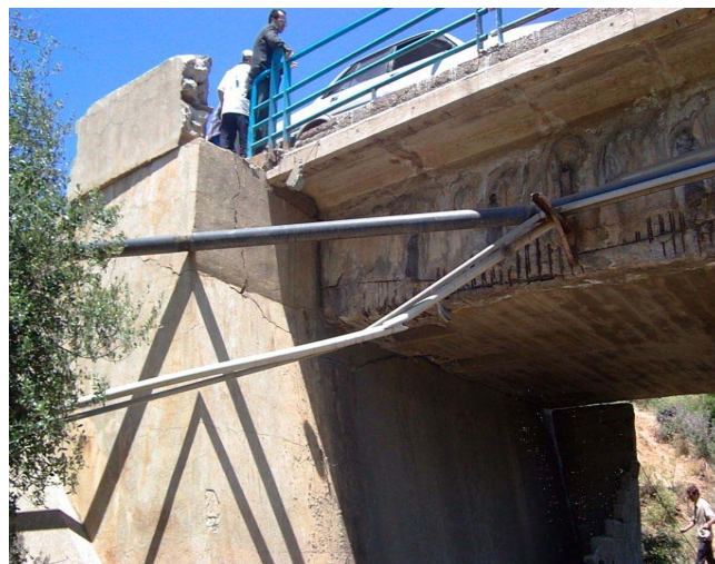
Figure 1.10 : Dégradation du tablier et de la culée du pont côté Heraoua [29]
