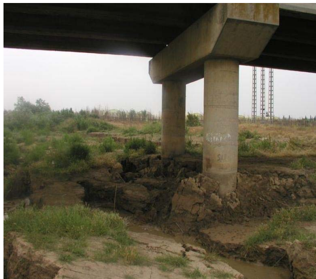
Figure 1.15 : Rupture du sol dû à la liquéfaction des berges à Oued Isser [29]
