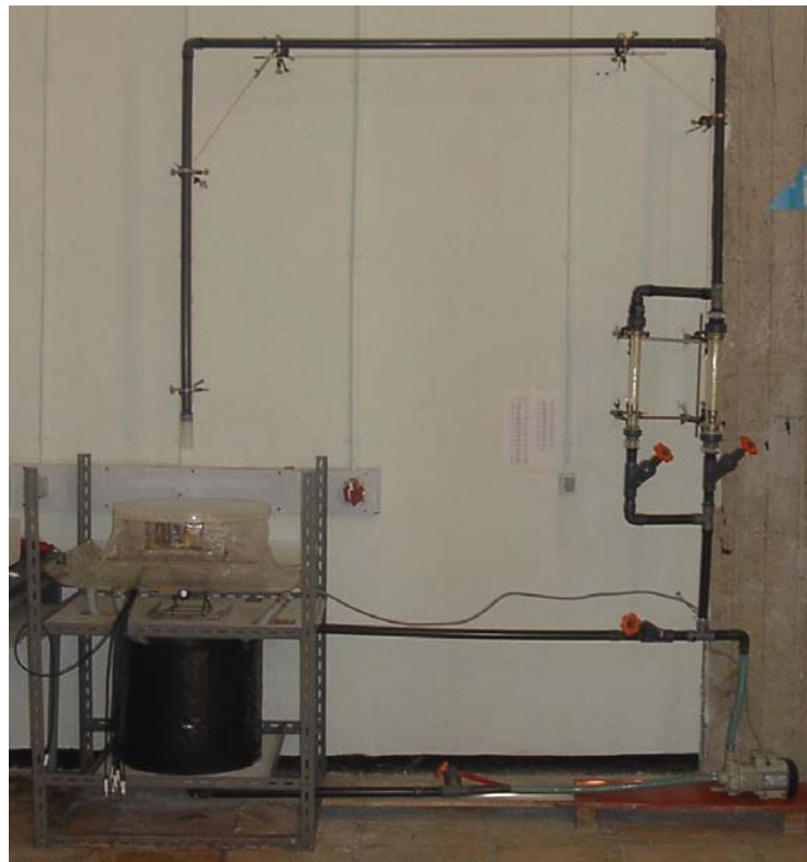
Photo (II-1) : Circuit Hydraulique.
