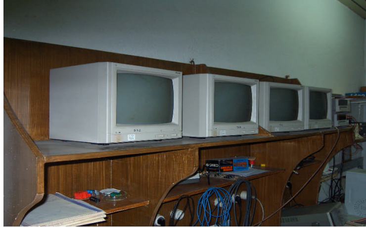
Figure.II. 3 Moniteurs de télé surveillance
