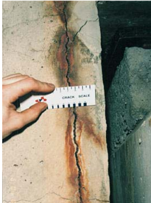
Figure III. 14 : Corrosion des armatures par les chlorures – piquures et coulée de rouille [112]
