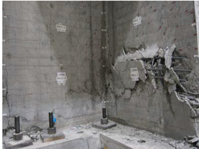
Figure 2.7 : Type de fissuration du voile L00A (d'après [34])
