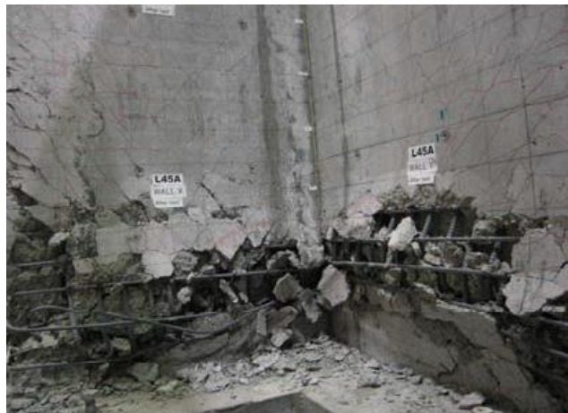
Figure 2.8 : Type de fissuration du voile L45A (d'après [34])
