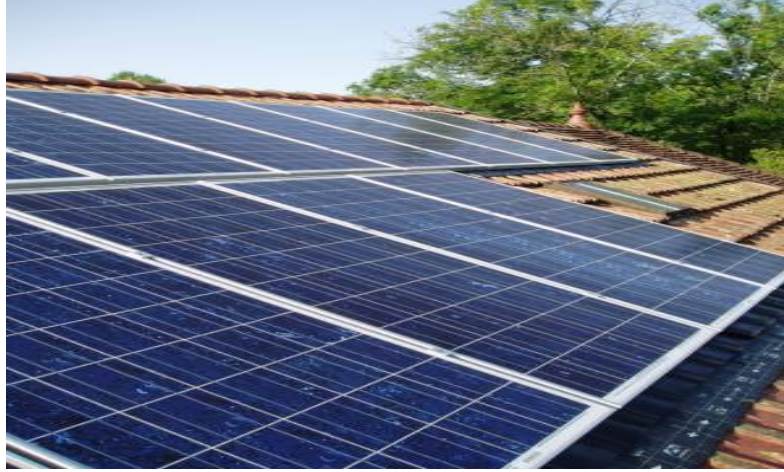
Figure I.34. Composantes d'un champ de modules photovoltaïques
