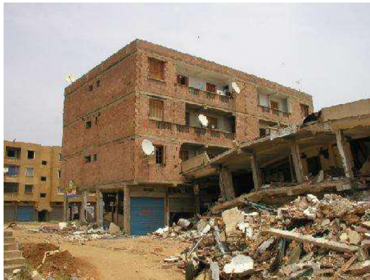
Photo I.1: bâtiment effondre en mille-feuille [24]
