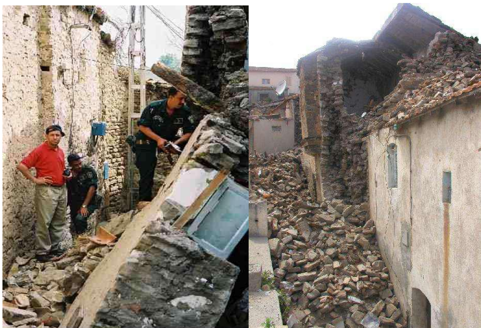
Photo I.5, I.6: effondrements des pièces (murs sont constitués à l'origine de moellons) [24].
