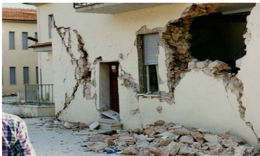
Photo III.1 : Fissuration et ruine des murs de contreventement sollicités dans leur plan[1]
