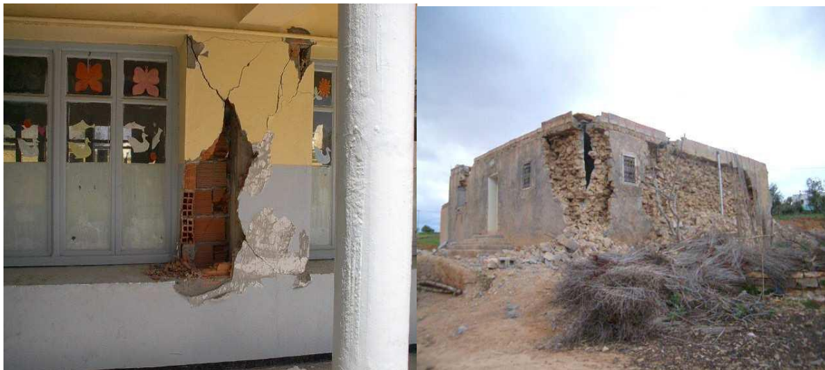
Photos III 2, III.3 : des bâtiments en maçonnerie briques rouges et de voiles en pierre (manque de chaînage) [44].
