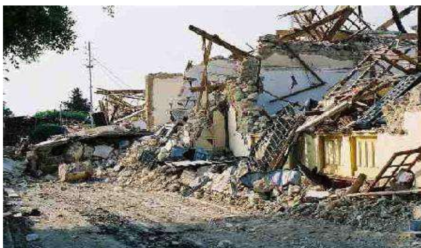
Photo I.8: effondrement (murs de 40 à 60 cm d'épaisseur à l'origine moellons, charpente en bois massif et couverture lourde en tuile) [24].
