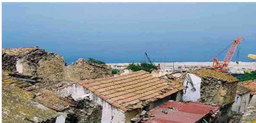
Photo I.2 : effondrements des murs (empilements de pierres [24] Sans liant)
