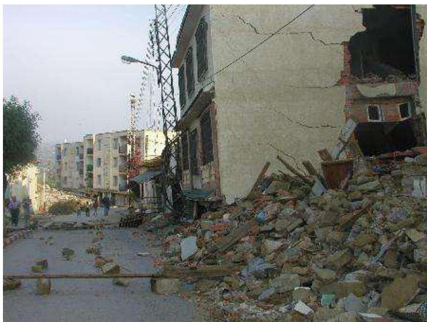
Photo I.9: effondrement (le poids important de l'ensemble de la structure) [24].
