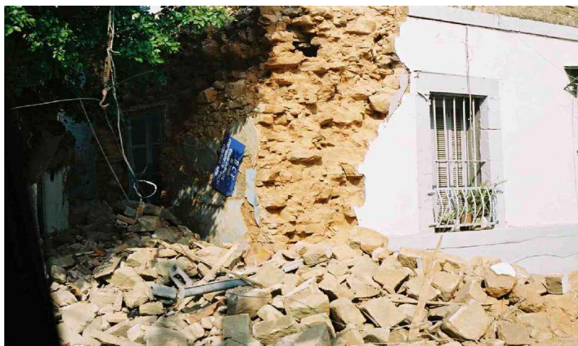
Photo I.7 : effondrement (les angles des ouvrages en maçonnerie très vulnérables) [24].
