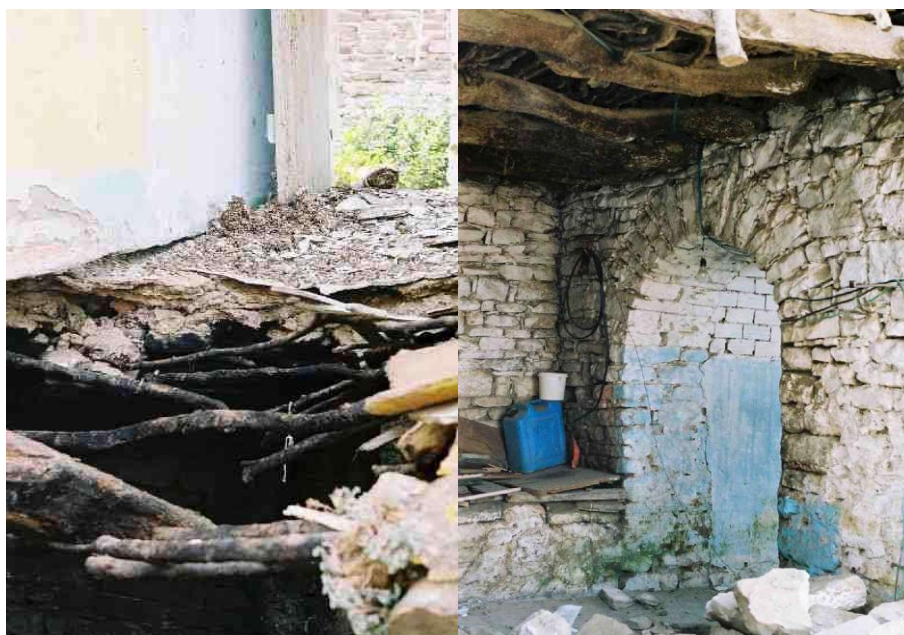
Photo I 3:les planchers de faible intégrité (poutres en tronc d'arbre avec des branches) [24] Photo I.4:la résistance des arcs de faible portée[24]
