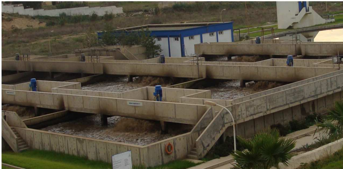
Figure 32 : Bassin d'aération (point TB).
