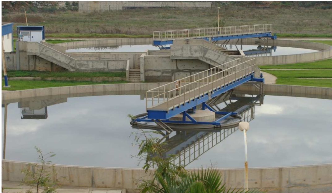
Figure 31 : Bassin de décantation primaire (point DP).
