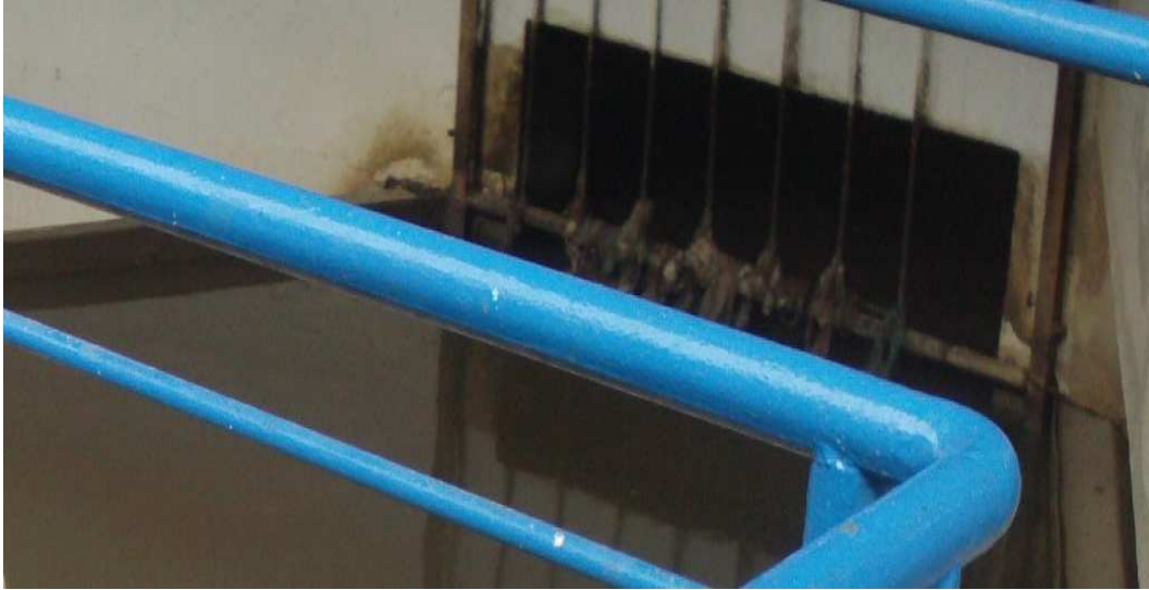
Figure 30 : déversoir d'arrivée des eaux de rejet (point EB).
