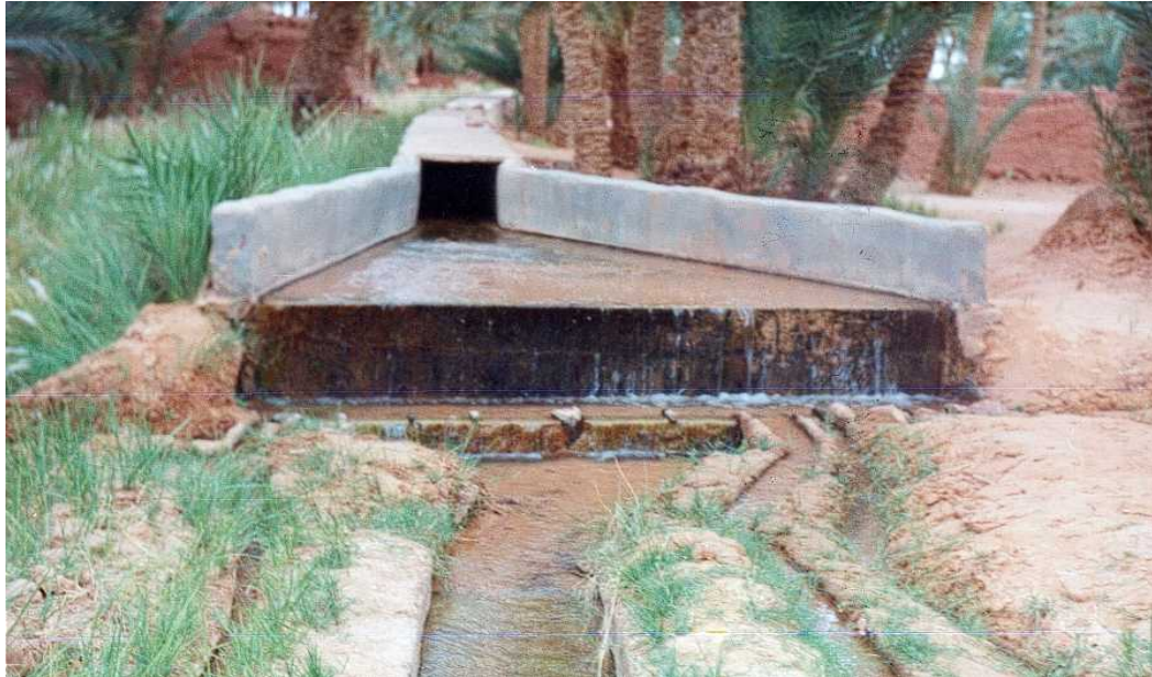
Figure 40: Peigne partiteur principal « Kasri » de la foggaras "Armoul" de Tamentit
