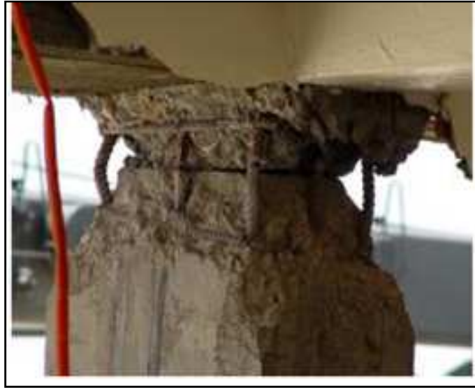
Photo B-I-3: Destruction de l'extrémité du poteau à cause de l'absence d'armatures transversales et présence de talonnette [30]
