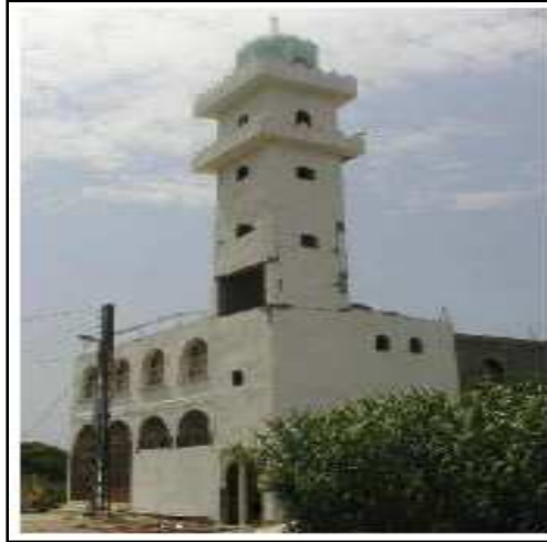
Photo B-I-7 : Défaut de conception, changement brutal de rigidité, nécessité d'un joint parasismique [2]
