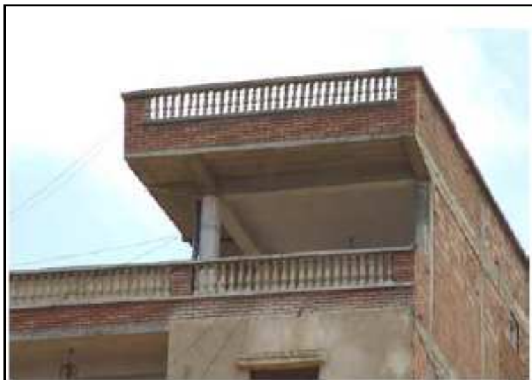
Photo B-I-4 : Construction présentant une irrégularité en élévation [30]
