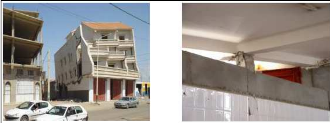
Photo B-I-5: Destruction des poteaux à cause du fonctionnement en poteaux courts [30]
