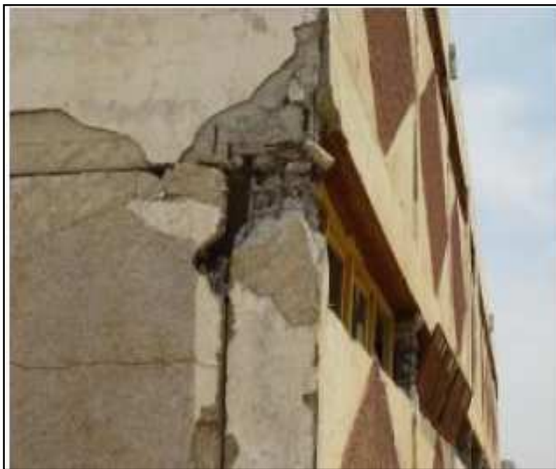
Photo B-I-6: Détail de destruction d'un poteau d'angle [30]
