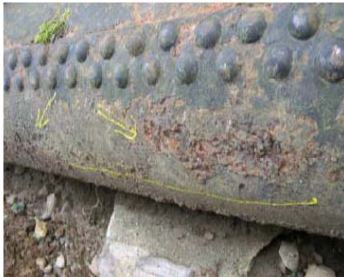
Figure I.1 : Perte d'épaisseur localisée affectant les conduites.
