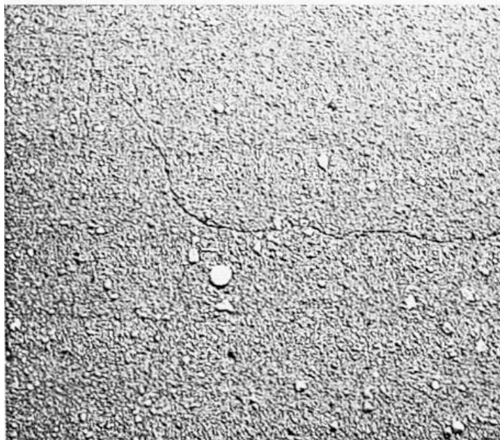
Fig III.33 : Remontée des fissures sur la section réalisée en sand Asfphalt [26]
