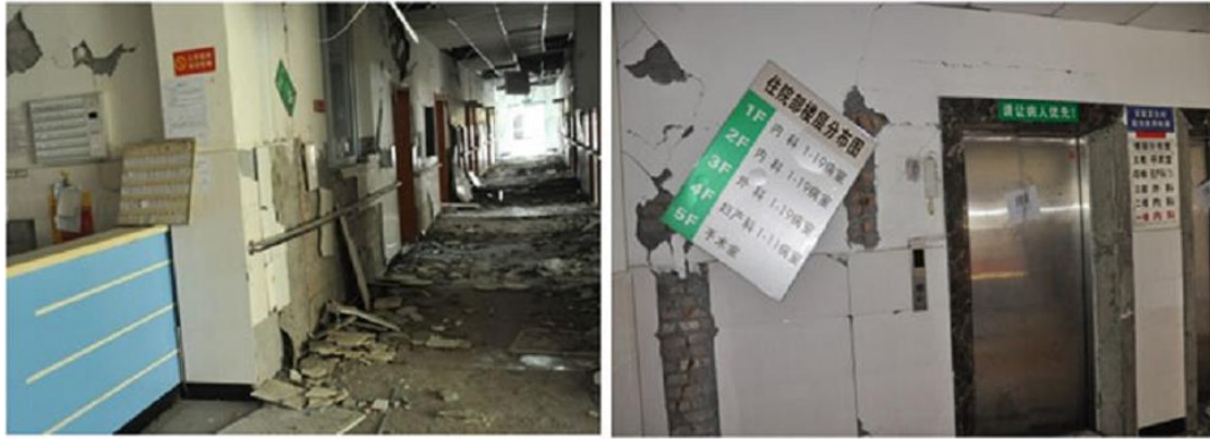
Figure 3.5: Dommages subis par les deux hôpitaux fondés classiquement
